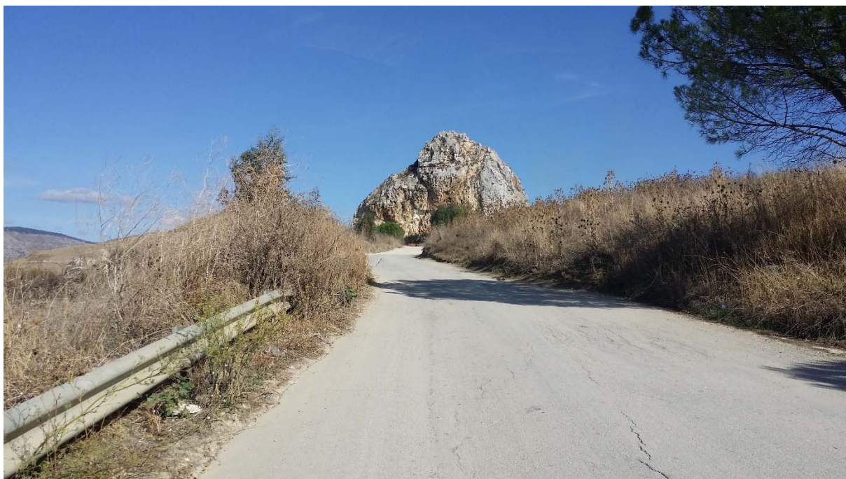
Fig. 47. Dissesto al km 9+300. Si osserva il tratto di strada non asfaltato per effetto dei dissesti e i grandi spostamenti verso valle subiti dalla carreggiata.
