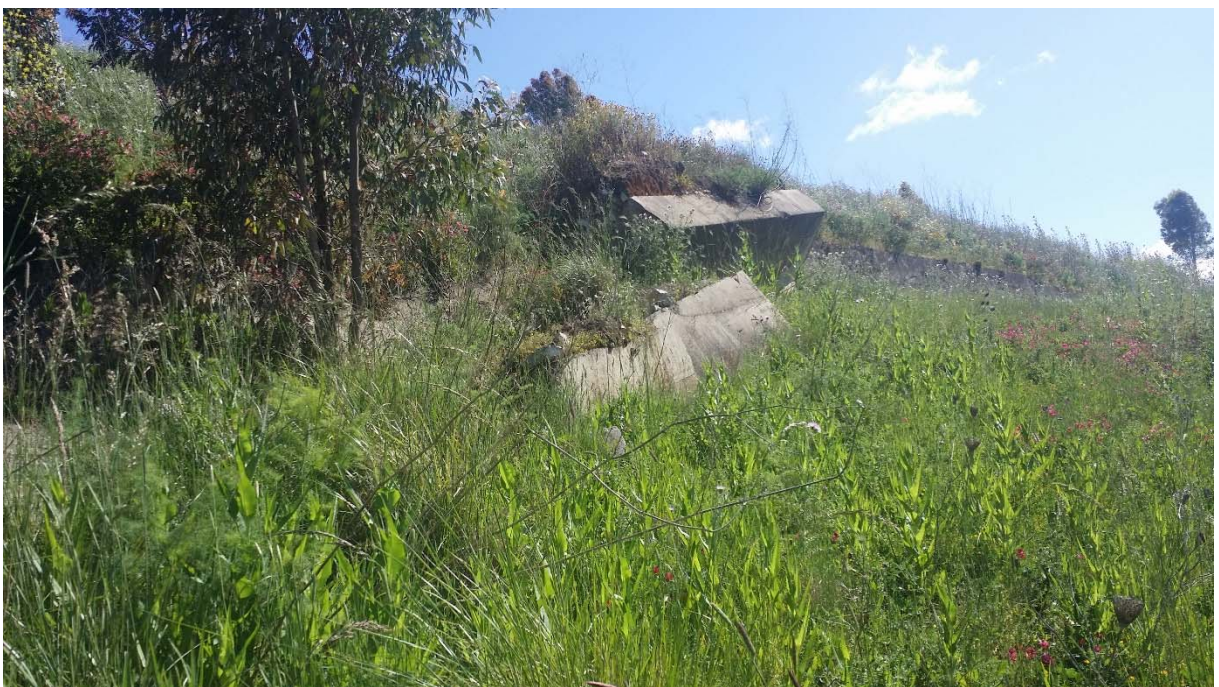
Fig. 34. Dissesto al km 9+000. A valle della strada si osservano tratti di muri di sostegno completamente divelti. Vista da valle.
