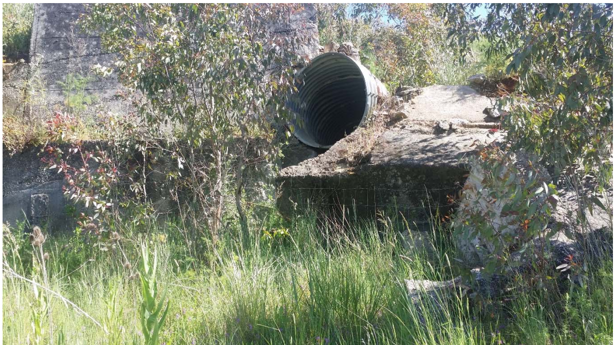
Fig. 36. Dissesto al km 9+000. Vista da valle dei muri dissestati e del tubo arco armco.
