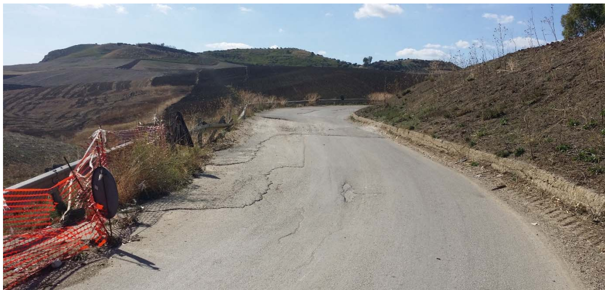
Fig. 62. Dissesto al km 18+400. Si nota la parziale rottura della sede stradale. Vista in direzione S. Cipirello.
