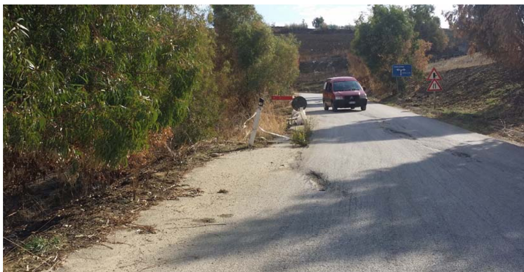
Fig. 27. Dissesto al km 8+700. Si osservano chiaramente le lesioni che si propagano verso monte e interessano quasi tutta la strada.
