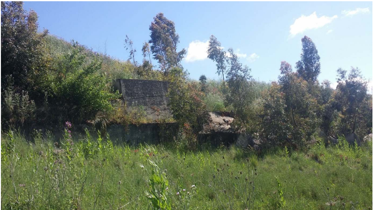
Fig. 33. Dissesto al km 9+000. A valle della strada si osservano tratti di muri di sostegno completamente divelti. Vista da valle.
