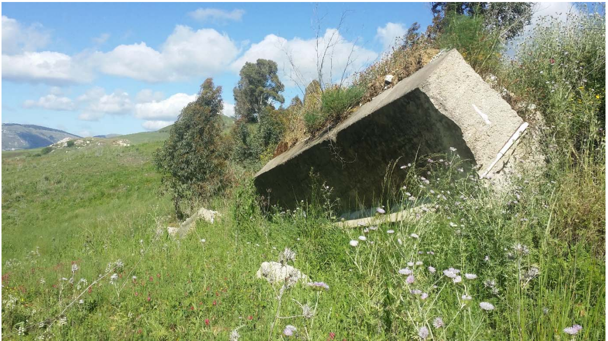
Fig. 35. Dissesto al km 9+000. Tronco di muro di sostegno completamente divelto che ha subito spostamento dell'ordine di 10m.
