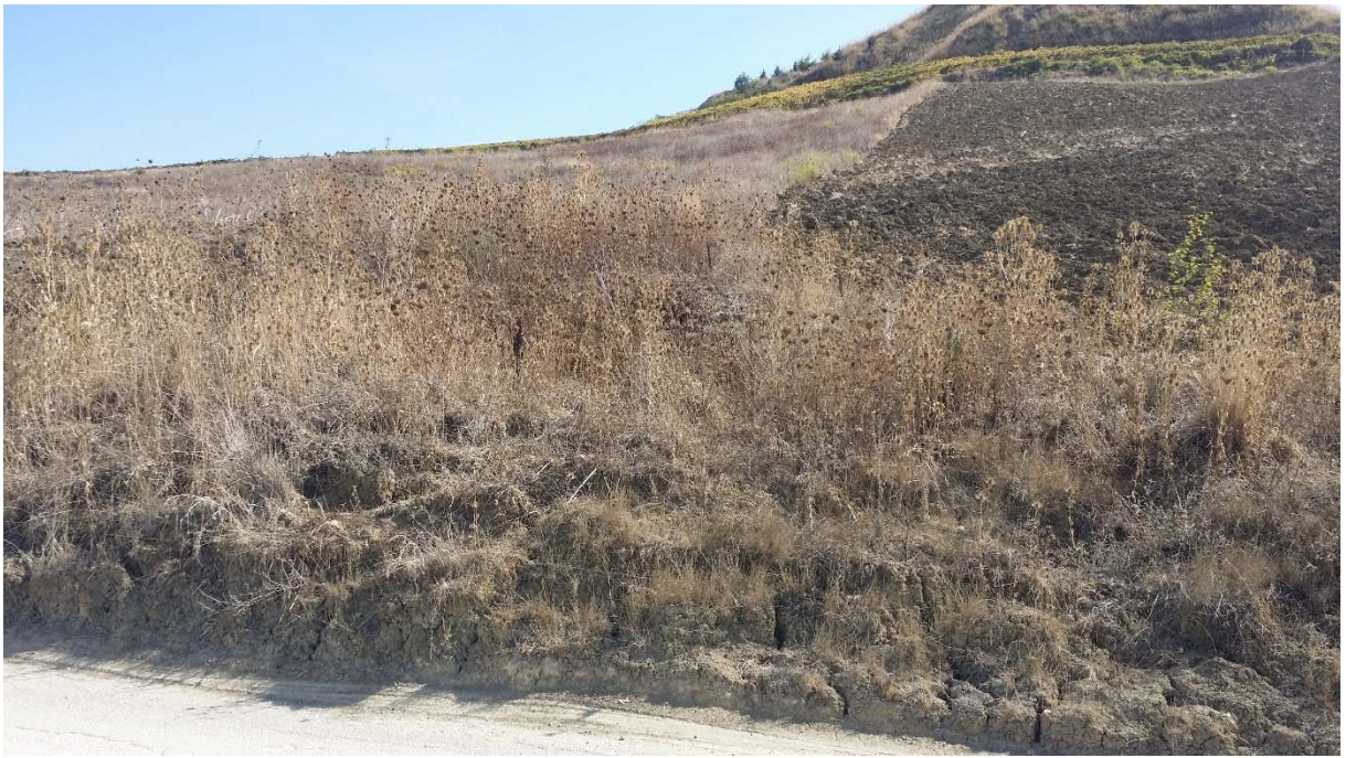
Fig. 45. Dissesto al km 9+300. Si nota materiale rimaneggiato sul lato di monte della strada che in occasione di piogge intense o prolungate si rimobilita e invade la strada. Vista verso monte.
