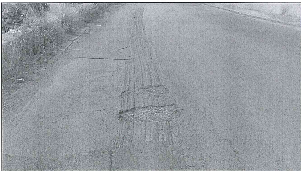
Foto n. 4 - Dissesti diffusi sede stradale alla progr.va km.ca 2+700 circa.
