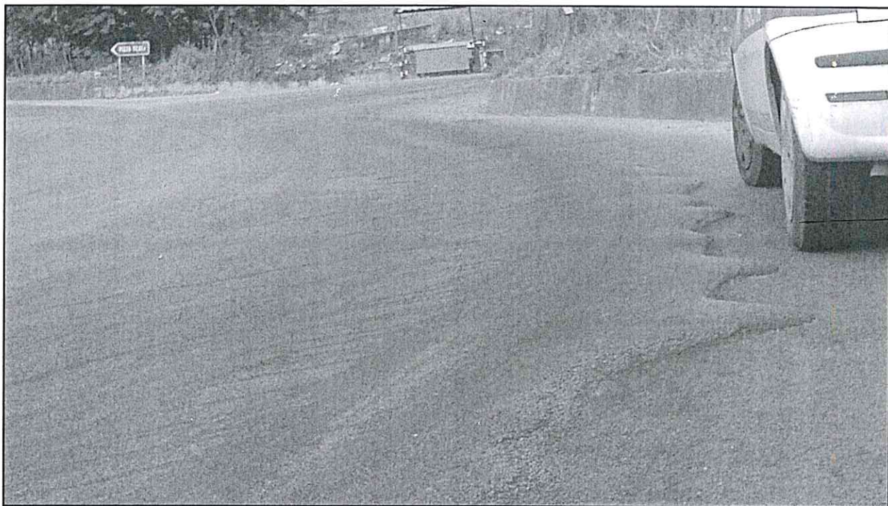
Foto n 11 - Dissesti diffusi sede stradale alla progr.va km.ca 4+500 (ingresso discarica R.S.U. di Bellolampo).
