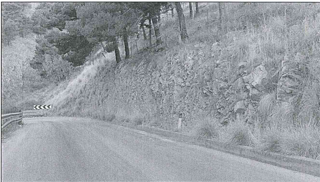
Foto n. 5 - Tratto sede stradale alla progr.va km.ca 3+100 circa (prevista rete protezione).
