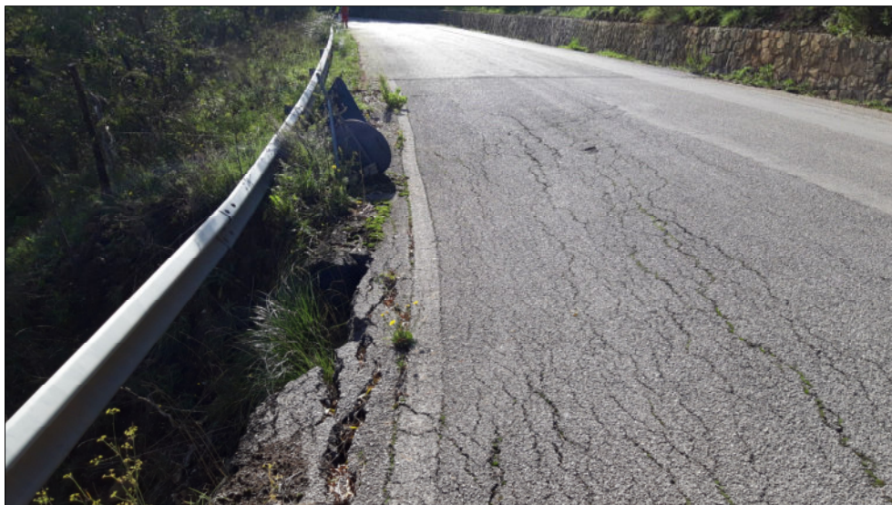
Strada Provinciale S.P. 52 Progressiva Km. 15+400.00 Tipol. criticità CEDIMENTO STRADALE Lato Valle
