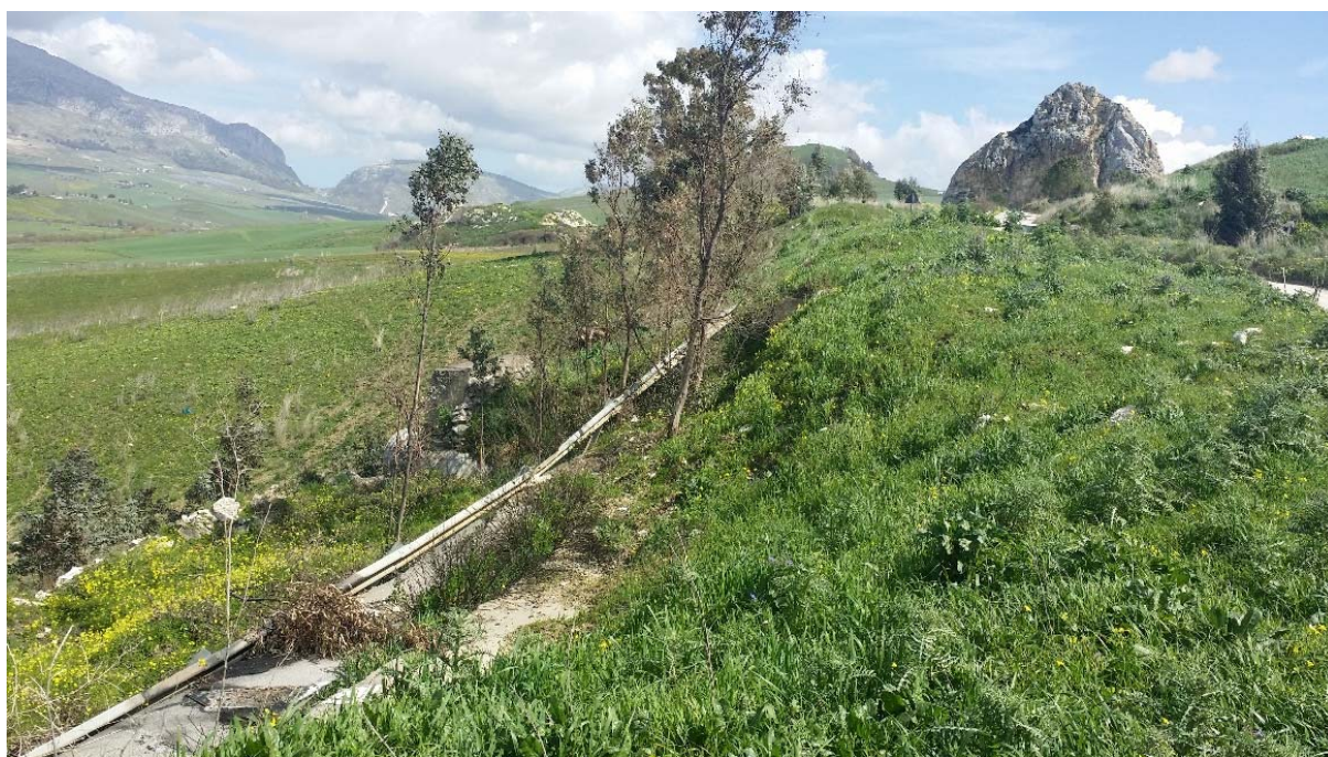
Fig. 32. Dissesto al km 9+000. A valle della strada si osservano tratti di muri di sostegno completamente divelti.
