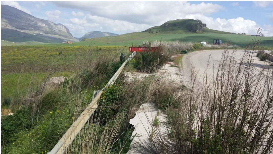
Fig. 56. Dissesto al km 9+800. Si nota la parziale rottura della sede stradale e i resti divelti di un muro di sostegno a valle (parte sinistra della foto). Vista in direzione Corleone.
