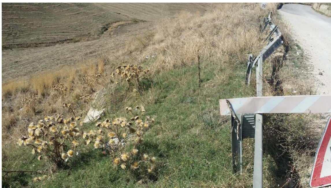
Fig. 71. Dissesto al km 19+000. Scarpata a valle della strada. Si nota un pezzo di muro di sostegno divelto a circa 4-5m dalla strada.
