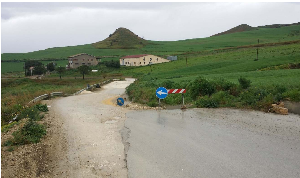
Fig. 77. Dissesto al km 22+700. Vista (in direzione S. Cipirello) della strada dissestata. Gli spostamenti subiti dalla strada sono di metri.
