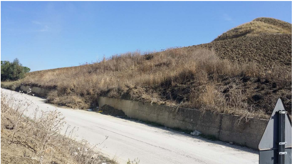
Fig. 40. Tratto fra i km 9+000 e 9+300. Per effetto delle elevate pressioni interstiziali nei periodi piovosi masse di terreno instabile evolvono in colate che invadono la strada.
