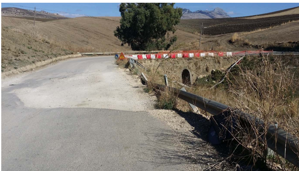
Fig. 63. Dissesto al km 18+400. Si nota la parziale rottura della sede stradale e il cedimento verso valle di parte della sede stradale. Vista in direzione Corleone.
