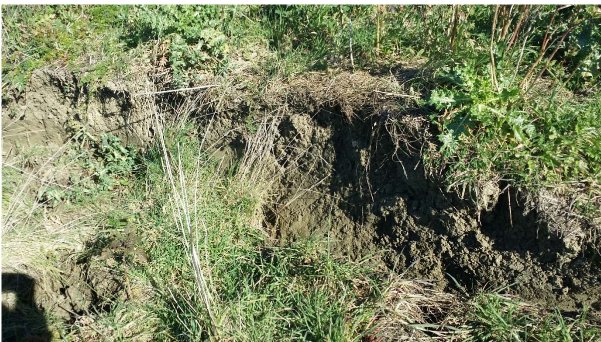
Fig. 53. Tratto fra i dissesti dal km 9+000 al km 9+300. Materiale completamente mobilizzato nei periodi invernali. Foto del 14 Febbraio 2019. Detto materiale nei periodi piovosi si mobilita, frana a valle e invade periodicamente la strada.
