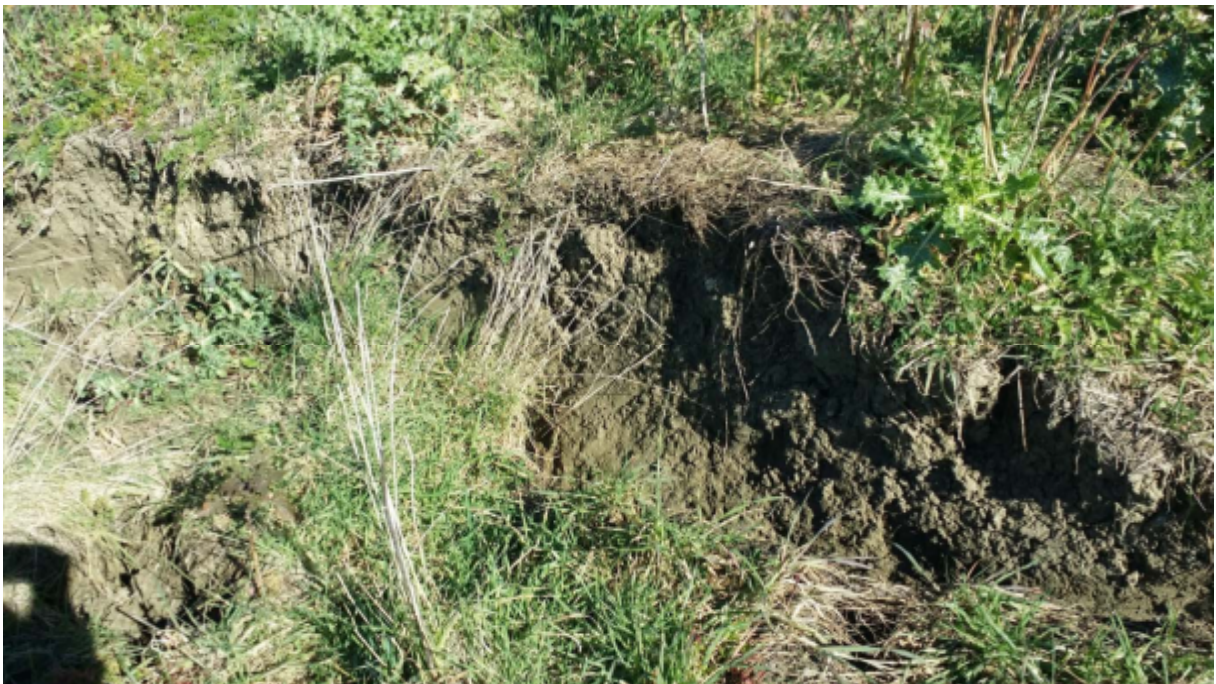
Fig. 53. Tratto fra i dissesti dal km 9+000 al km 9+300. Materiale completamente mobilizzato nei periodi invernali. Foto del 14 Febbraio 2019. Detto materiale nei periodi piovosi si mobilita, frana a valle e invade periodicamente la strada.
