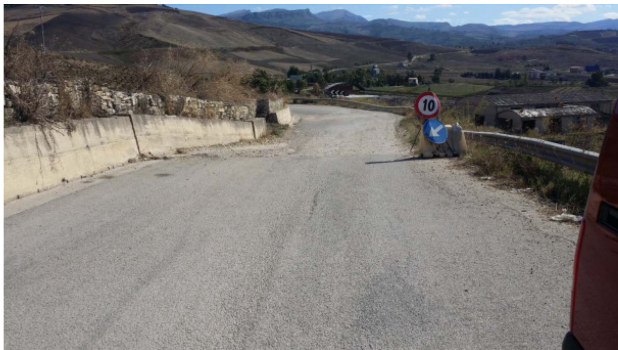
Fig. 69. Dissesto al km 19+000. Si nota il muro di sostegno e i gabbioni sconnessi e la parziale rottura della sede stradale. Vista in direzione Corleone.
