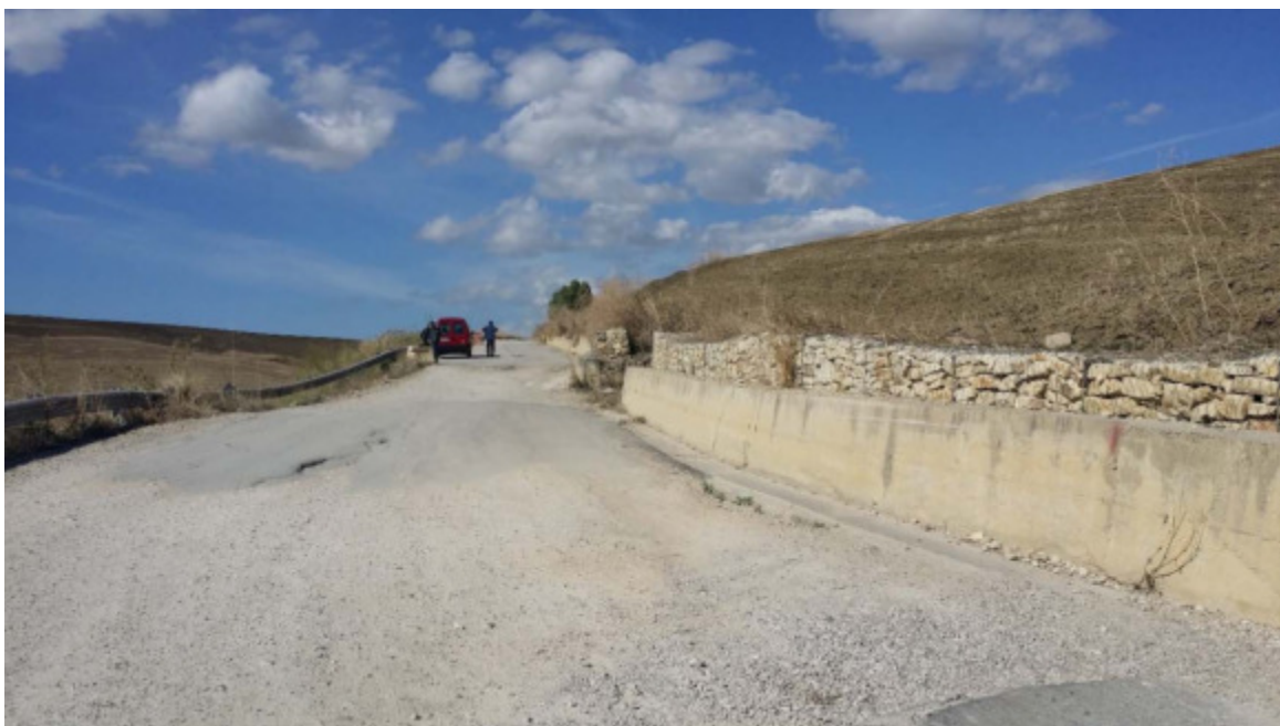
Fig. 70. Dissesto al km 19+000. Si nota il muro di sostegno e i gabbioni sconnessi e l'avvallamento della sede stradale. Vista in direzione S. Cipirello.
