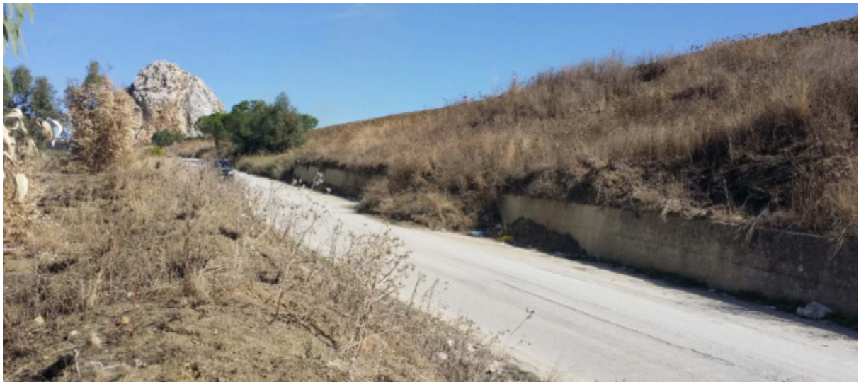
Fig. 52. Tratto fra i dissesti dal km 9+000 al km 9+300. Si osserva materiale franato sulla strada e materiale completamente mobilizzato e in procinto di franare.
