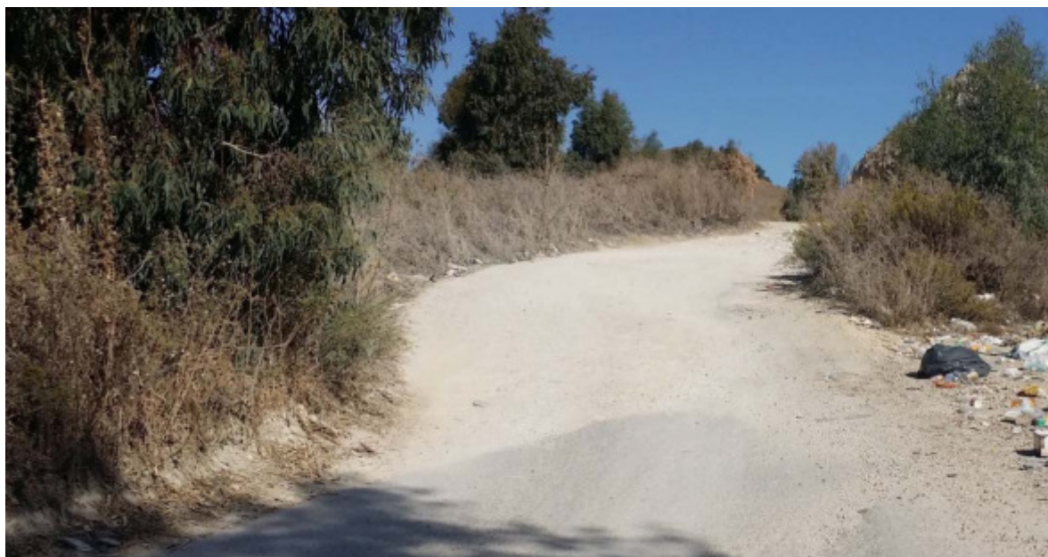
Fig. 31. Dissesto al km 9+000. Si nota la deviazione della carreggiata stradale con il materiale di riporto impiegato per il ripristino della strada.
