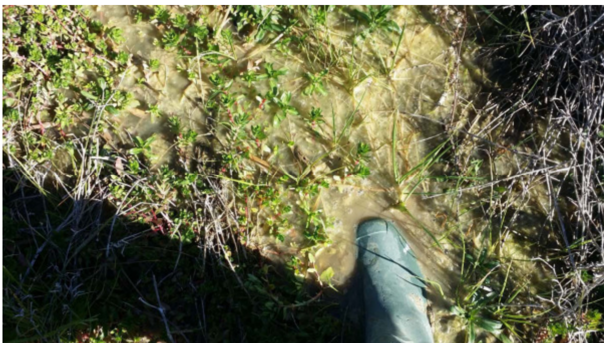
Fig. 50. Dissesto al km 9+300. Si osserva il ristagno di acqua con falda a piano campagna in prossimità del sondaggio S7 (ubicato a monte della strada, cfr. planimetria di figura 3). Foto scattata il 14 Febbraio 2019.
