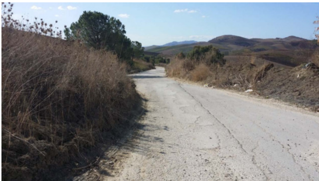
Fig. 44. Dissesto al km 9+300. Si nota la deviazione della carreggiata stradale con il materiale franato in più riprese accumulato a valle, e materiale in movimento nella parte di monte della strada.
