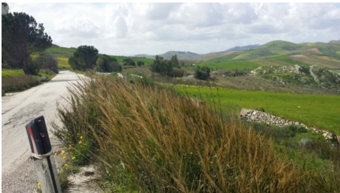
Fig. 57. Dissesto al km 9+800. Si nota la parziale rottura della sede stradale e i resti divelti di un muro di sostegno a valle (parte destra della foto). Vista in direzione S. Cipirello.
