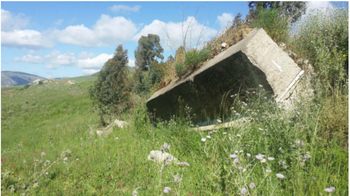
Fig. 35. Dissesto al km 9+000. Tronco di muro di sostegno completamente divolto che ha subito spostamento dell'ordine di 10m.
