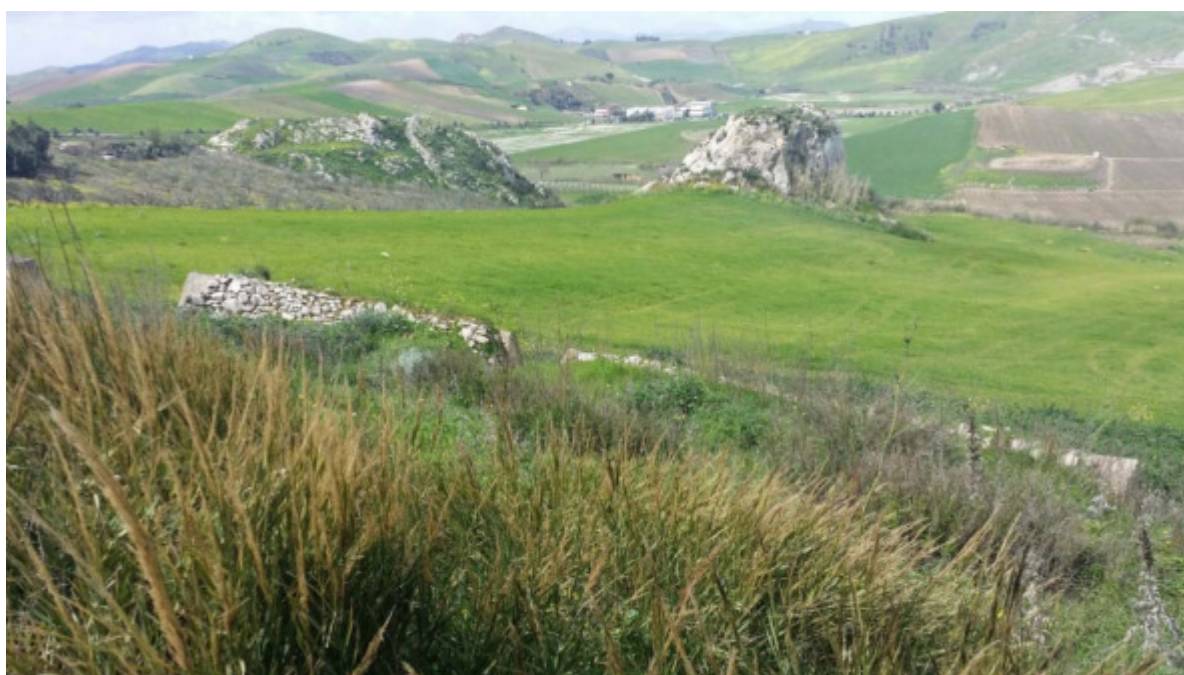
Fig. 58. Dissesto al km 9+800. Vista del muro di sostegno completamente ruotato e traslato più di 10m.
