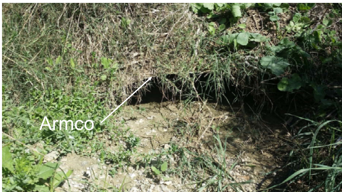
Fig. 86. Dissesto al km 22+800. Tubo armco esistente all'uscita quasi del tutto ostruito.
