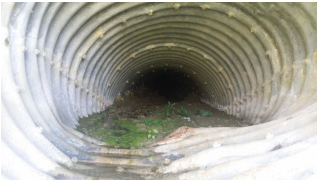
Fig. 37. Dissesto al km 9+000. Particolare del tubo armco, quasi completamente schiacciato e in contropendenza.
