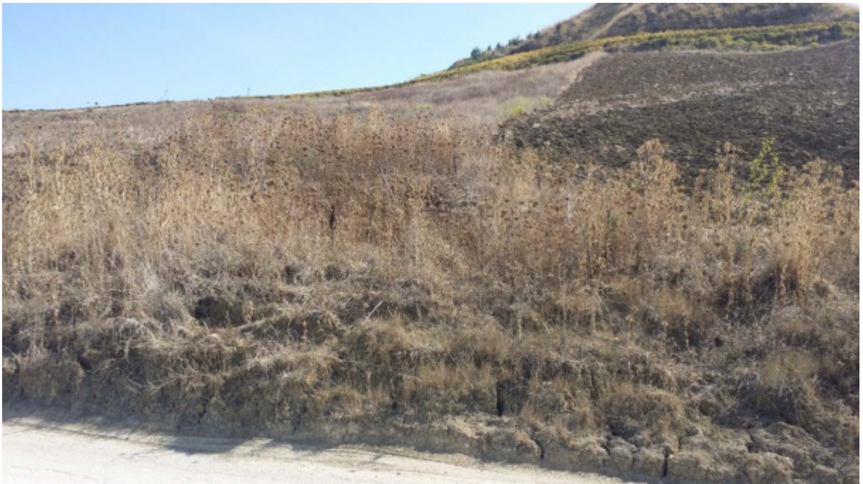
Fig. 45. Dissesto al km 9+300. Si nota materiale rimaneggiato sul lato di monte della strada che in occasione di piogge intense o prolungate si rimobilita e invade la strada. Vista verso monte.
