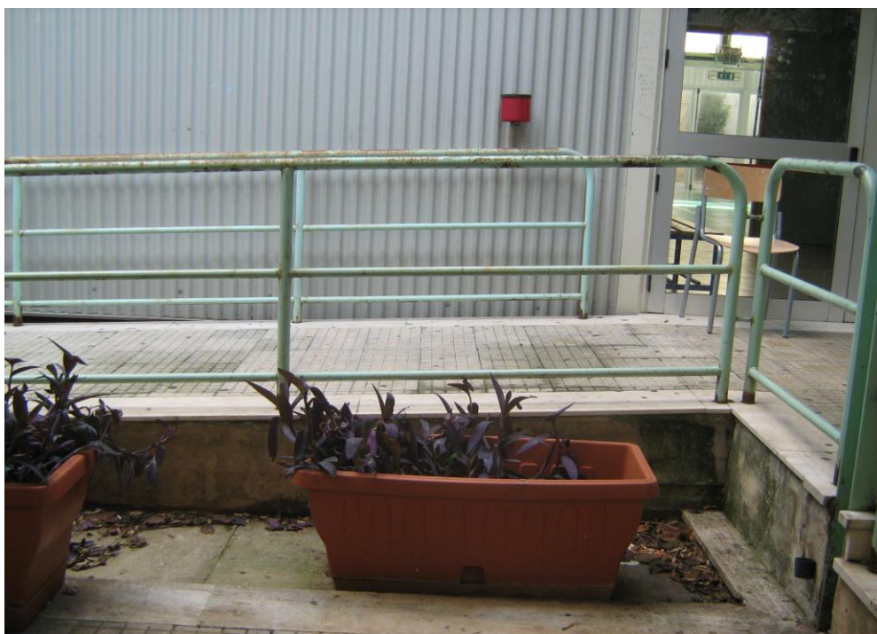
Foto n. 6 - Spazi esterni da ripristinare.
