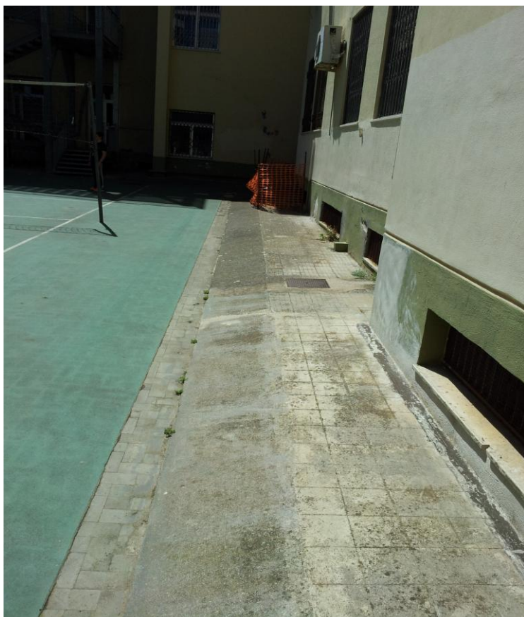
Foto 2 – Tratto di fognatura da rifare
