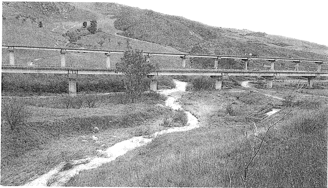
Foto n.6 Torrente Guardiola: tratto a valle del ponte
