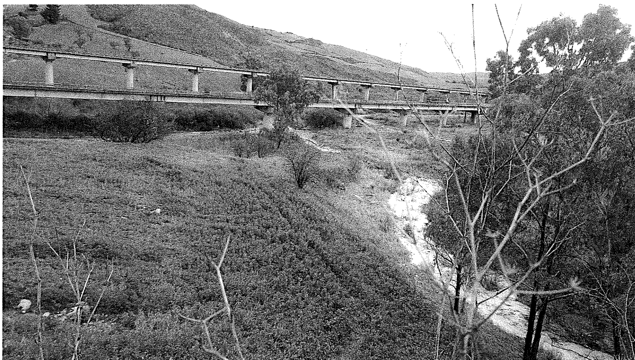
Foto n. 1 – Torrente Guardiola: tratto a valle del ponte
