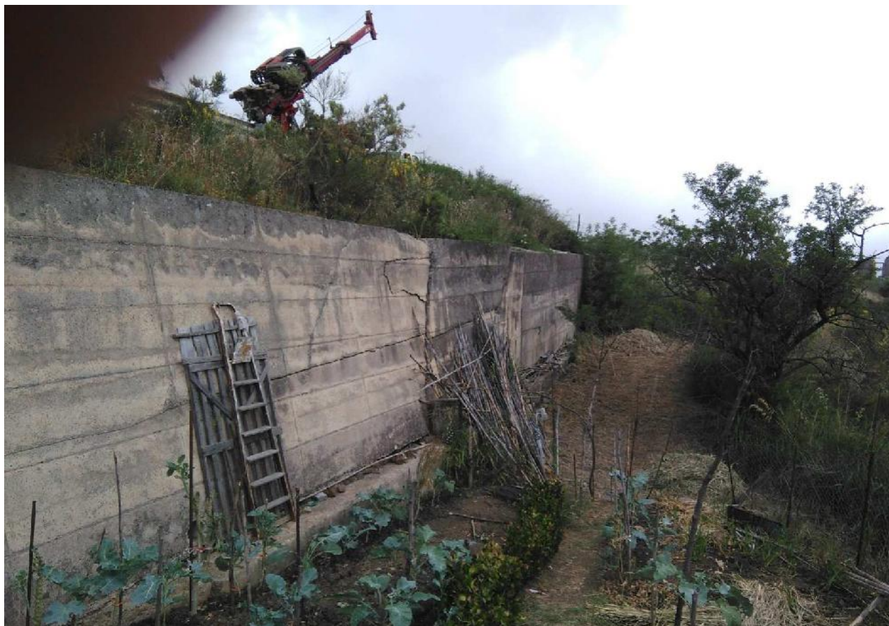
Fig. 5. Dissesto al km 27+100. A valle della strada si osservano tratti di muro di sottoscarpa parzialmente divelti. Vista da valle in direzione Isnello.
