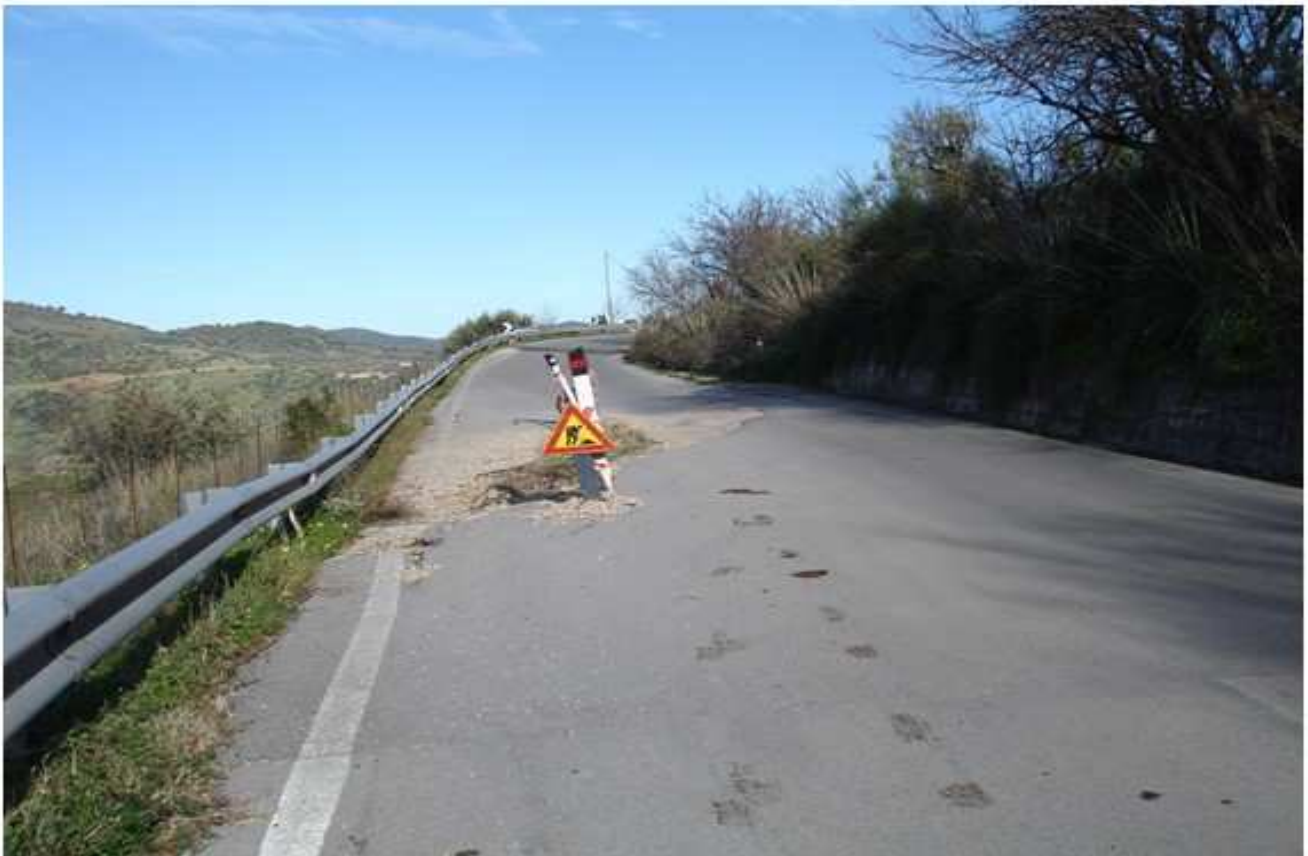
Fig. 3. Dissesto al km 28+700. Si nota la parziale rottura della sede stradale e il cedimento verso valle di parte della sede stradale. Vista in direzione Castelbuono.
