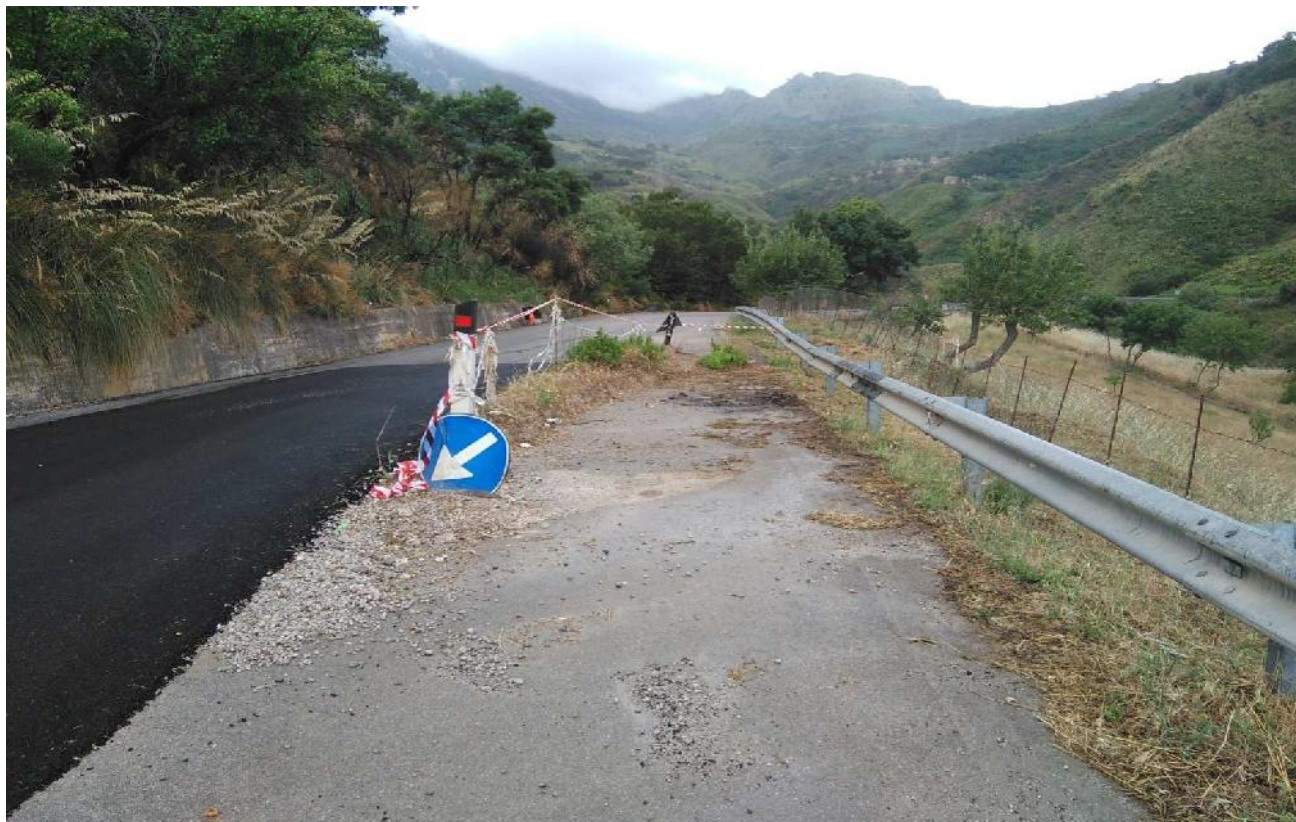
Fig. 2. Dissesto al km 28+700. Si nota la parziale rottura della sede stradale e il cedimento verso valle di parte della sede stradale. Vista in direzione Isnello.
