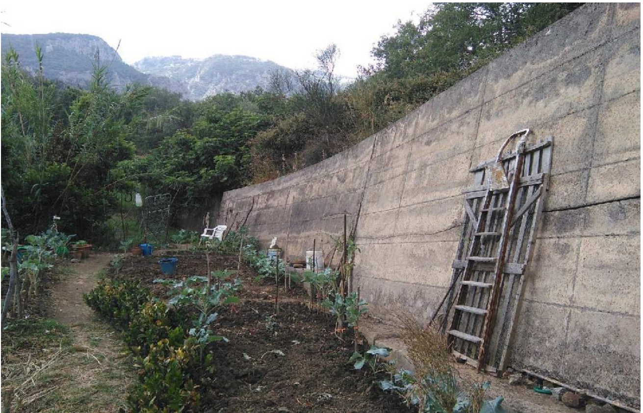
Fig. 4. Dissesto al km 27+100. Muro di sottoscarpa a valle. Vista da valle in direzione Castelbuono.
