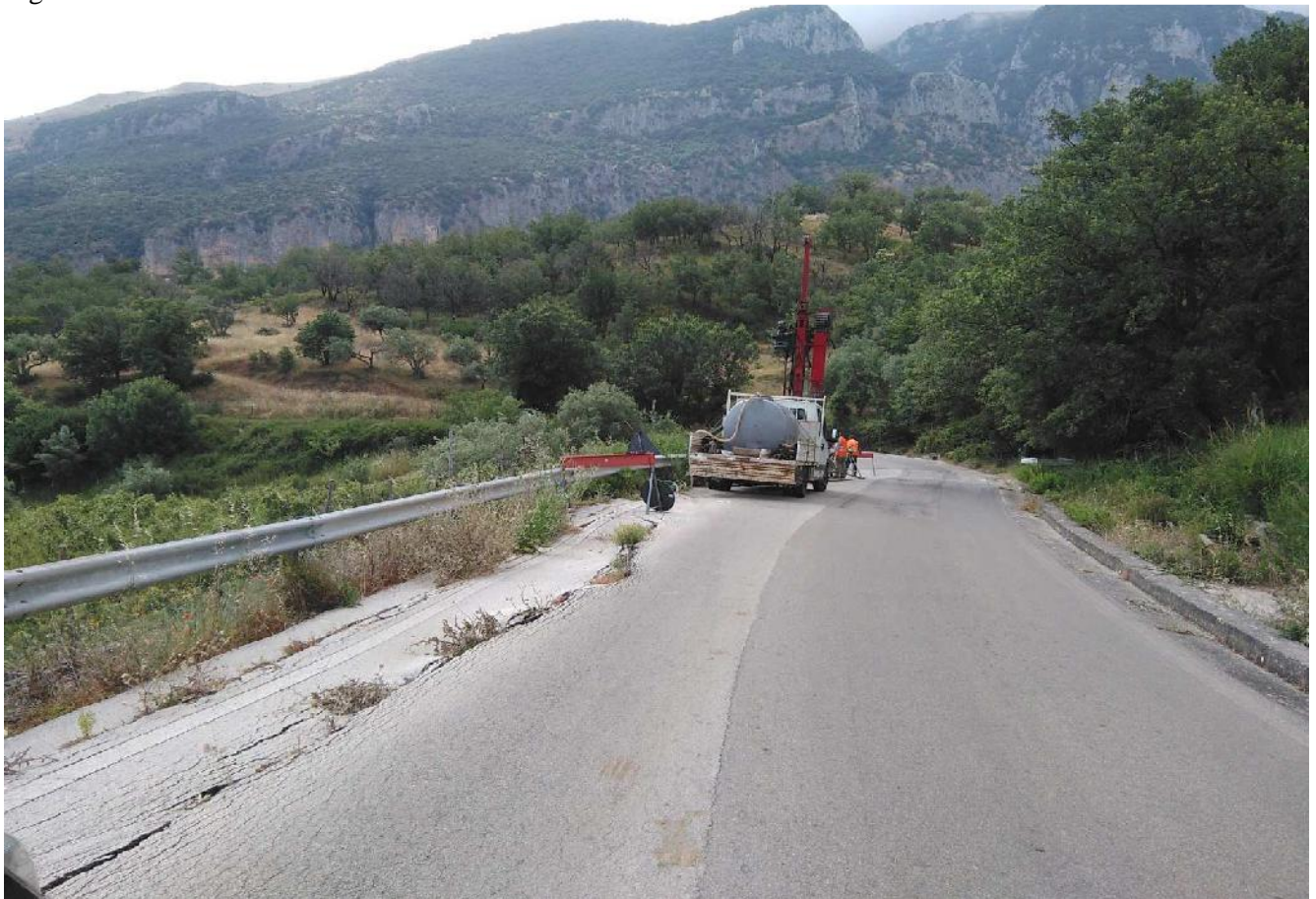
Fig. 2. Dissesto al km 27+100. Si nota la parziale rottura della sede stradale e il cedimento verso valle di parte della sede stradale. Vista in direzione Castelbuono.
