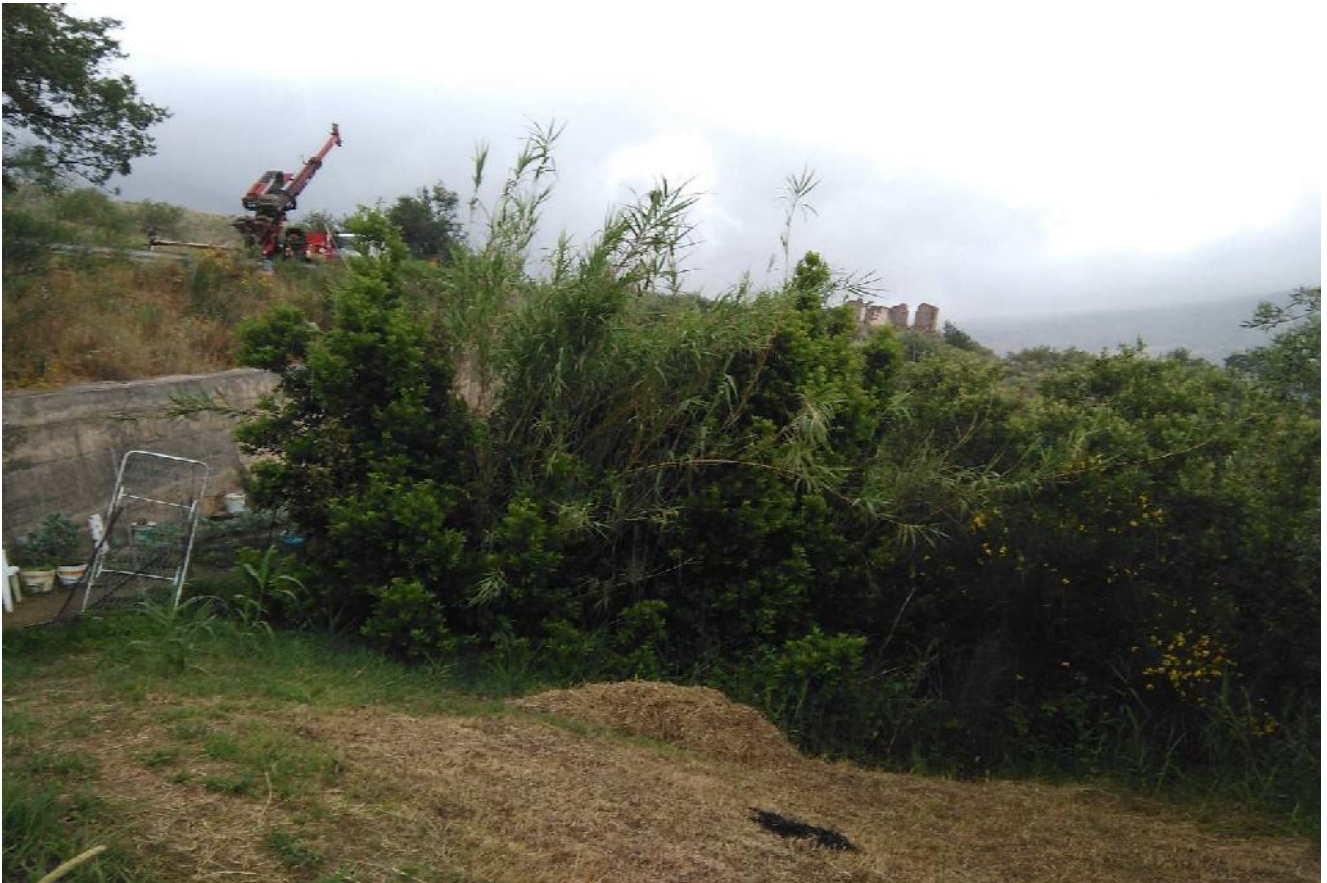
Fig. 3. Dissesto al km 27+100. Muro di sottoscarpa a valle. Vista da valle in direzione Isnello.
