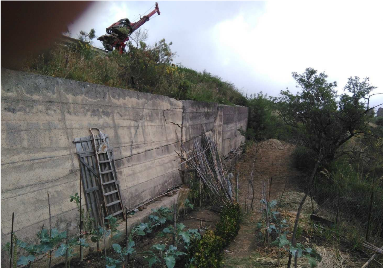
Fig. 6. Dissesto al km 27+100. A valle della strada si osservano tratti di muro di sottoscarpa parzialmente divelti. Vista da valle in direzione Isnello.
