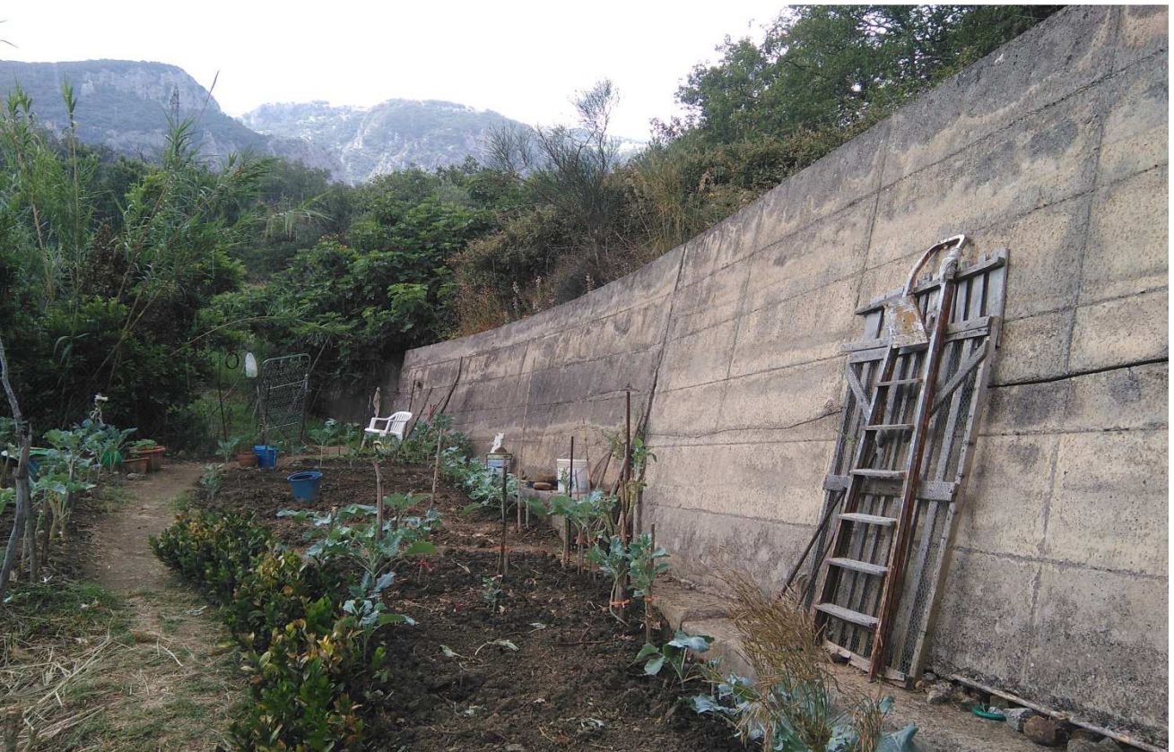
Fig. 5. Dissesto al km 27+100. Muro di sottoscarpa a valle. Vista da valle in direzione Castelbuono.
