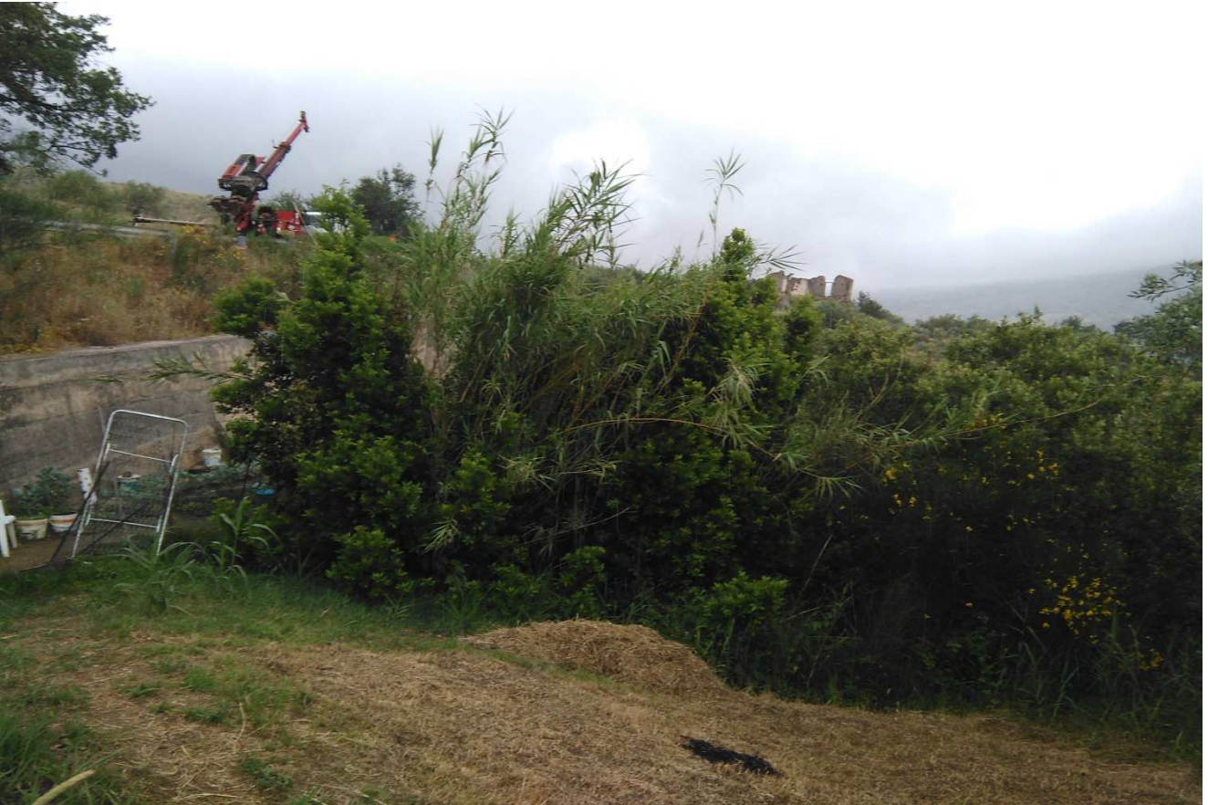
Fig. 4. Dissesto al km 27+100. Muro di sottoscarpa a valle. Vista da valle in direzione Isnello.
