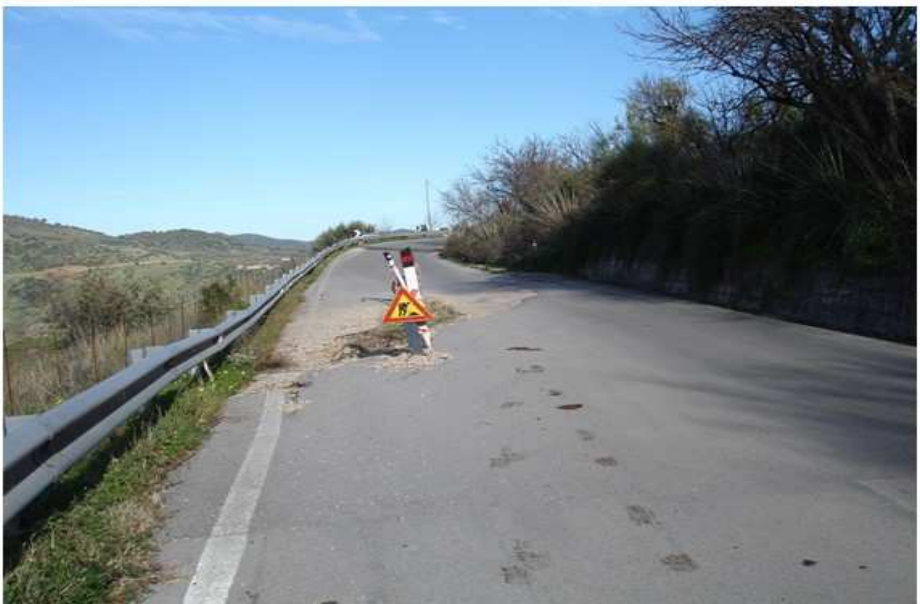
Fig. 4. Dissesto al km 28+700. Si nota la parziale rottura della sede stradale e il cedimento verso valle di parte della sede stradale. Vista in direzione Castelbuono.
