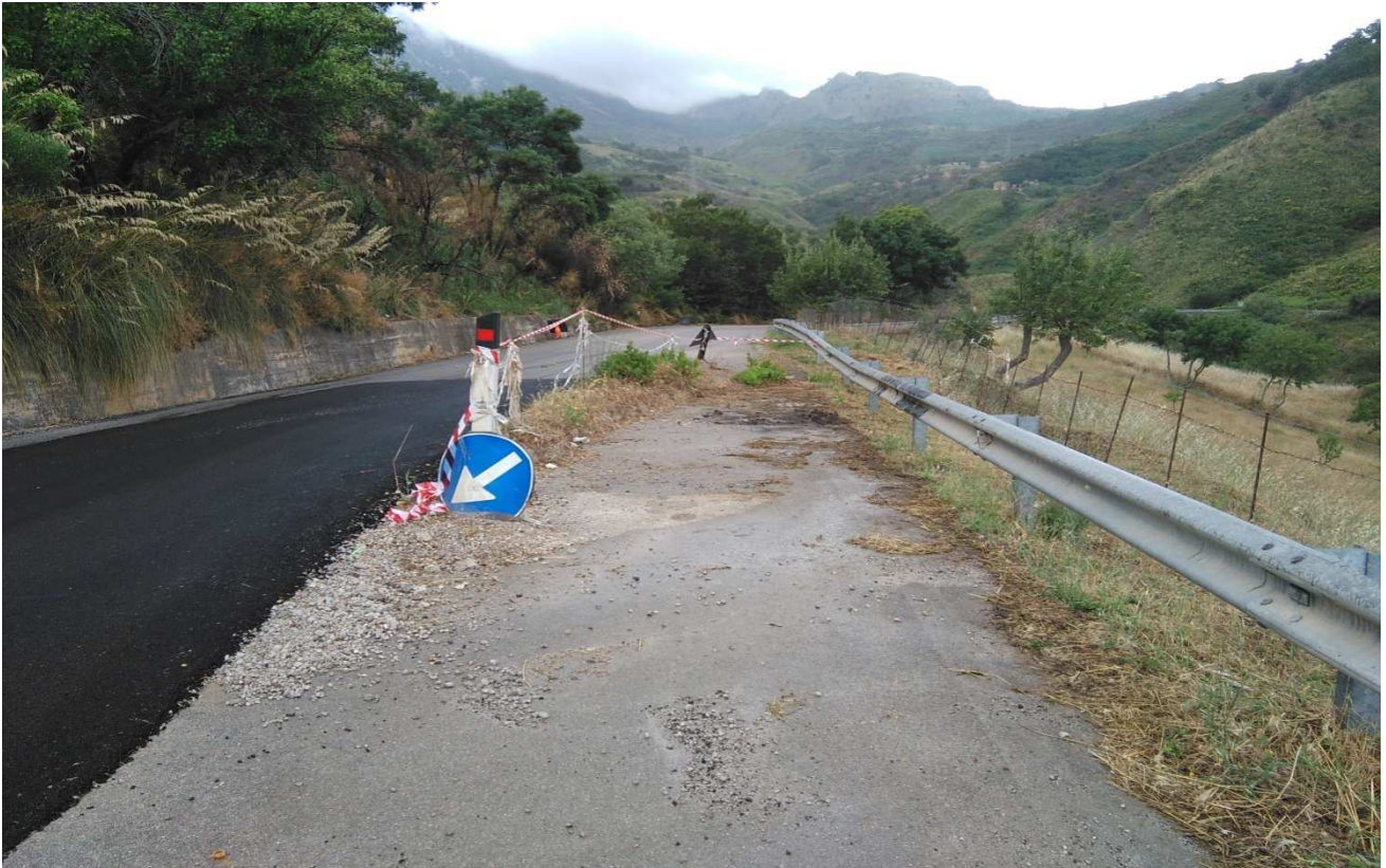
Fig. 3. Dissesto al km 28+700. Si nota la parziale rottura della sede stradale e il cedimento verso valle di parte della sede stradale. Vista in direzione Isnello.
