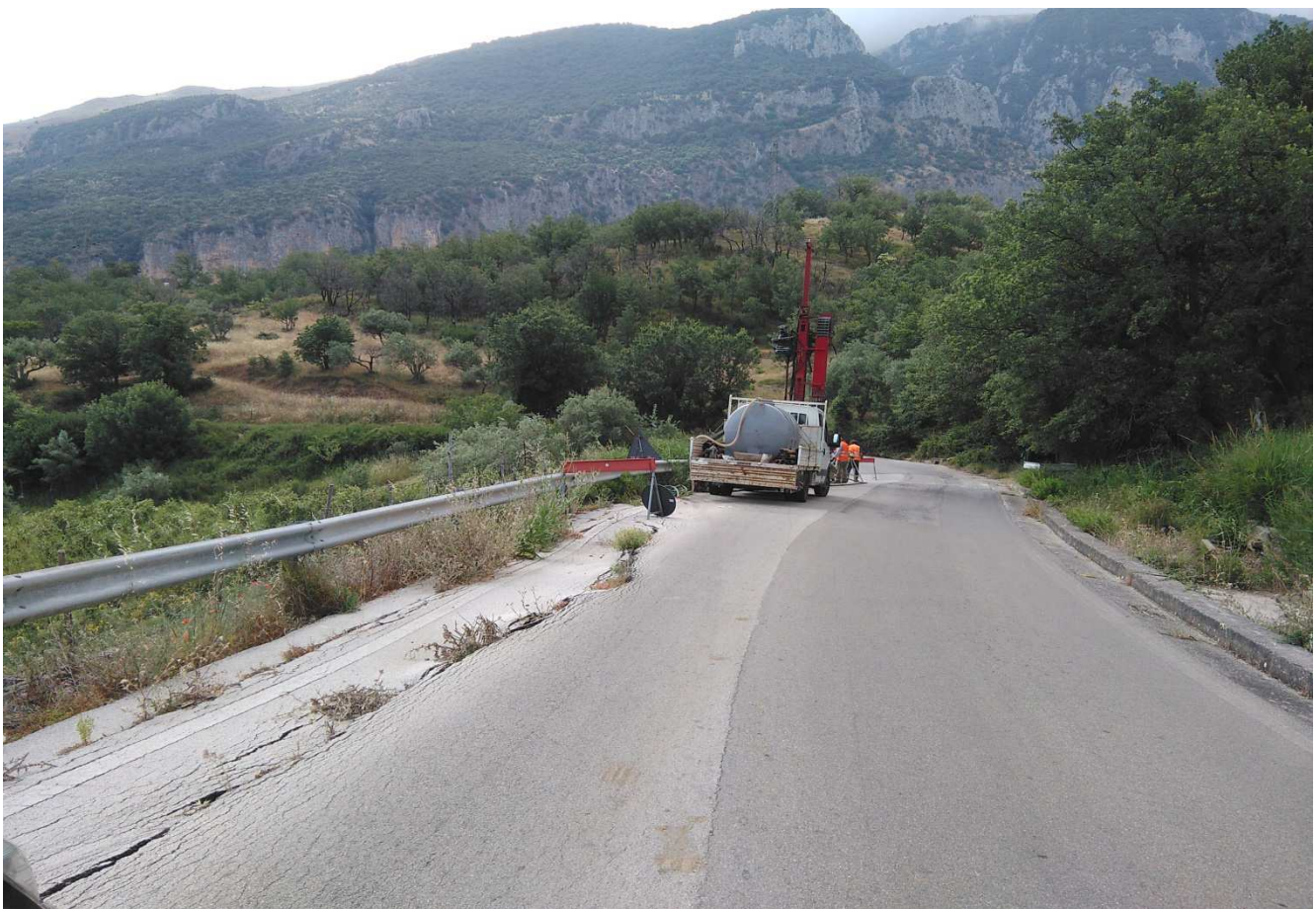
Fig. 3. Dissesto al km 27+100. Si nota la parziale rottura della sede stradale e il cedimento verso valle di parte della sede stradale. Vista in direzione Castelbuono.
